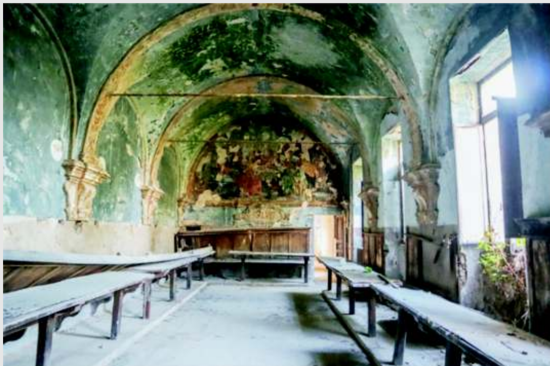
L'aspetto fatiscente dell'antico salone adibito a refettorio con volta a botte decorata a stucco che conserva ancora gli scranni lignei originali.
