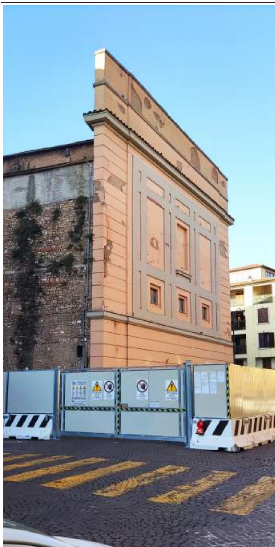
Il retro dell’edificio teatrale con il cantiere appena avviato su largo Sant’Agape.
