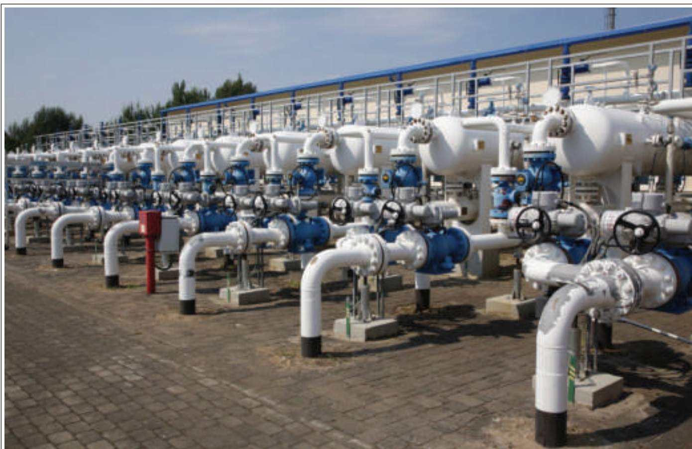
Figura 1- Terminale per la distribuzione del gas
