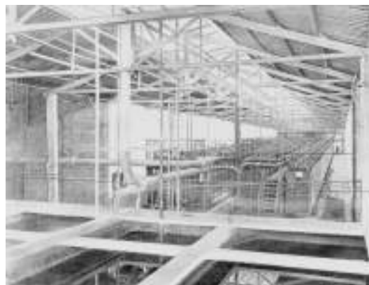
Sopra, compressori della miscela, punto 6 dello schema. Da sinistra: le pompe di circolazione, punto 11 dello schema, e i quadri; uno scorcio della sala degli elettrolizzatori (f) dai bacini del refrigerante.
