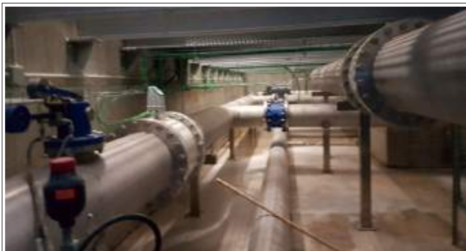
Tubazioni di raccordo all'interno del serbatoio di compenso in loc. Terria
