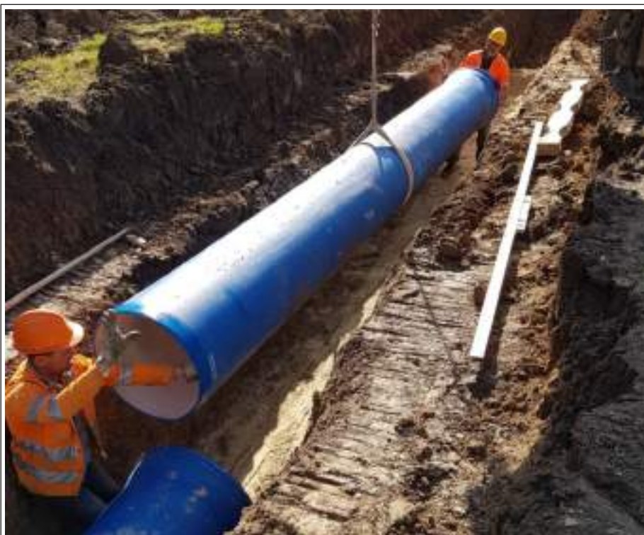
fase di lavoro di posa in opera della condotta su terreno agricolo
