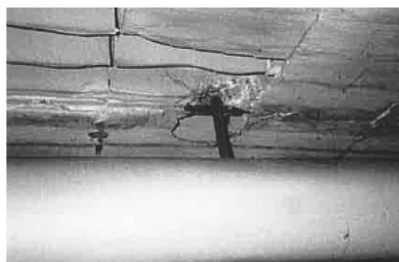
Figura 5: sfondellamento locale provocato dall'installazione della tubazione dovuto alla modalità invasiva di aggancio degli impianti che ha comportato la rottura del travetto in cls, lo scoprimento della barra di armatura e la saldatura del pendolino. Notevole la rottura dei setti verticali del blocco.
