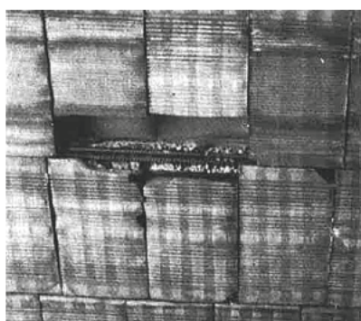
Figura 6: barre aderenti all'ala inferiore del blocco e prive di ricoprimento.
