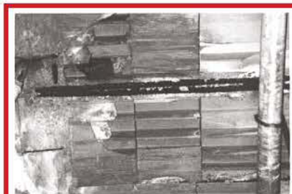
Figura 2: sfondellamento causato da cattivo riempimento del travetto (manca il cls sotto l'acciaio teso) e da eccessiva compressione sulla cartella inferiore dei blocchi. Insufficienza della fascia piena all'appoggio del solaio dovuta al momento flettente negativo.
