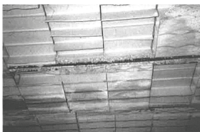
Figura 4: sfondellamento dovuto all'effetto combinato del cattivo riempimento dei travetti e della non adeguata resistenza dei setti verticali dei blocchi. Trattasi di sfondellamento esteso.
