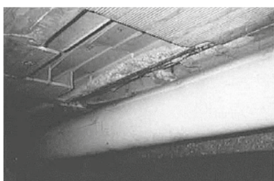
Figura 3: sfondellamento dovuto a cattivo riempimento dei travetti e all'inserimento nei blocchi di pendinature non adatte per sostenere la tubazione.
