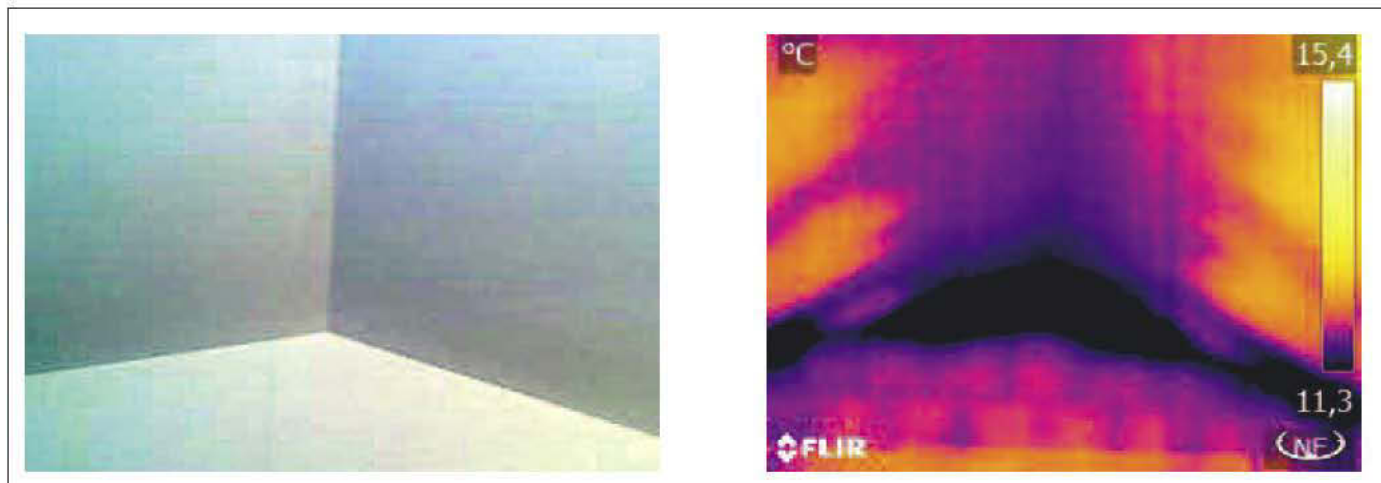
Rilevazione di alcune infiltrazioni d'acqua provenienti da una copertura a doppia falda
