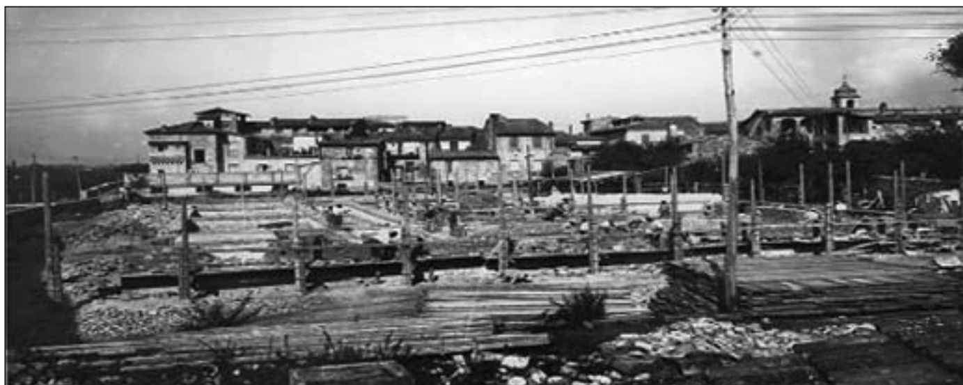
La foto documenta la gettata delle fondazioni del plesso scolastico. Sullo sfondo a destra è riconoscibile la cupola del campanile della Cattedrale di Terni., mentre a sinistra si intravede il tetto dell'edificio della G.I.L., in seguito sede dell'Istituto d'Arte.
