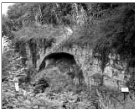
Ponte del Toro sommerso da terra ed erbacce
