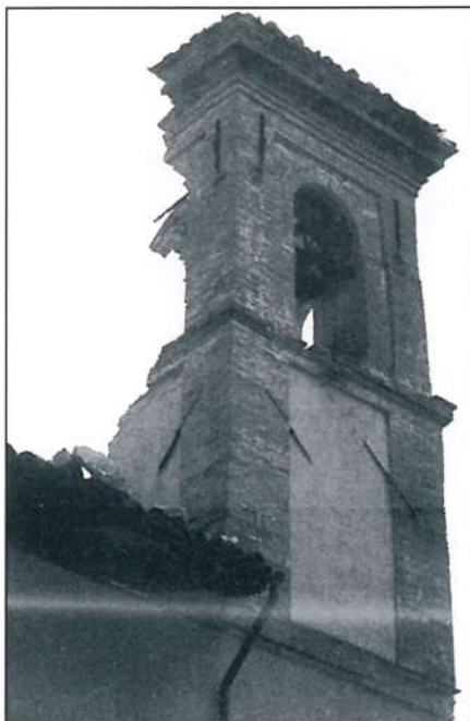
Il campanile della chiesa di S. Carlo a Camerino dopo la prima scossa (in alto) e dopo la seconda (in basso).
