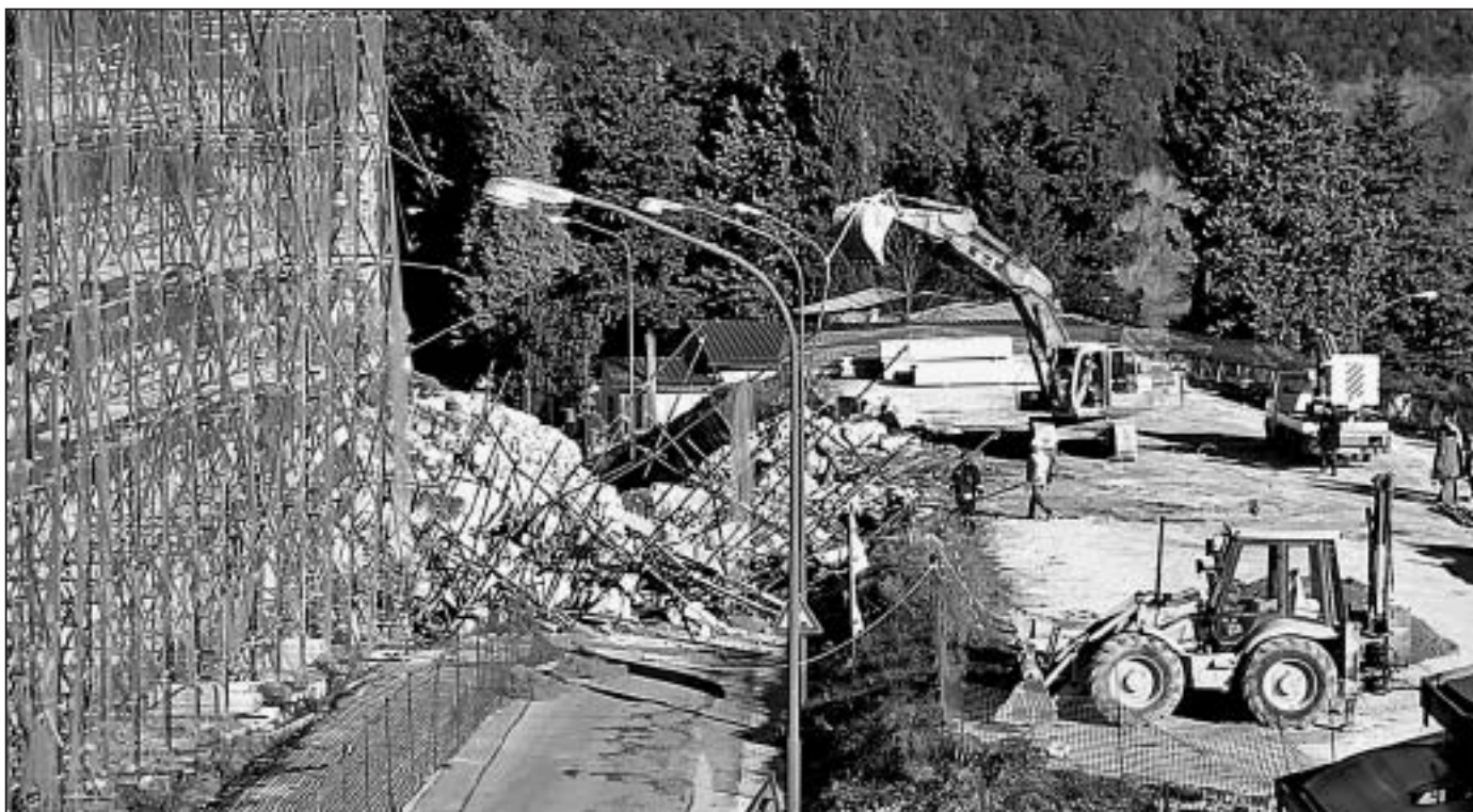
Un aspetto del crollo di cinta muraria avvenuto il 18 gennaio 2006
