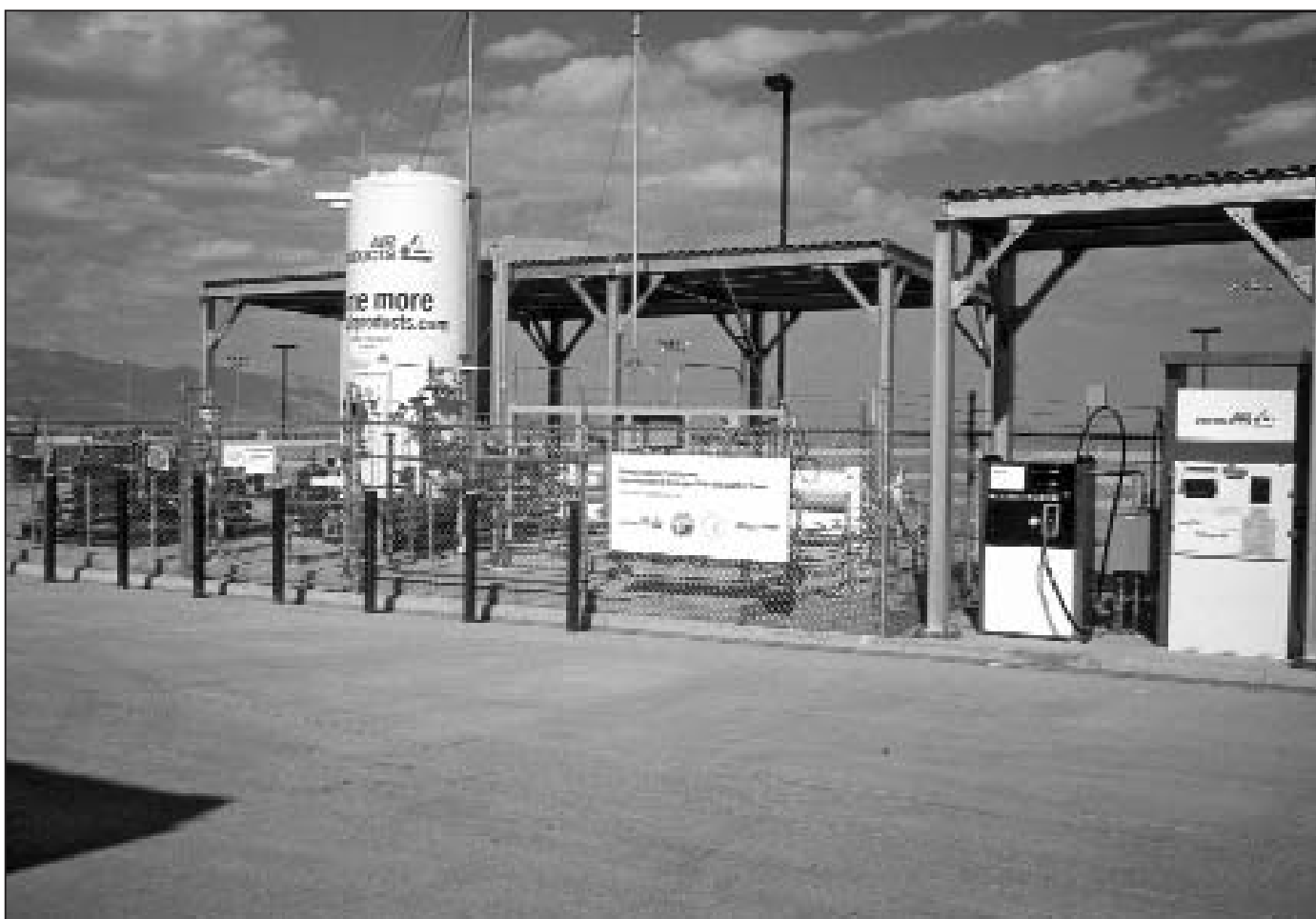
Una stazione di rifornimento di Idrogeno
