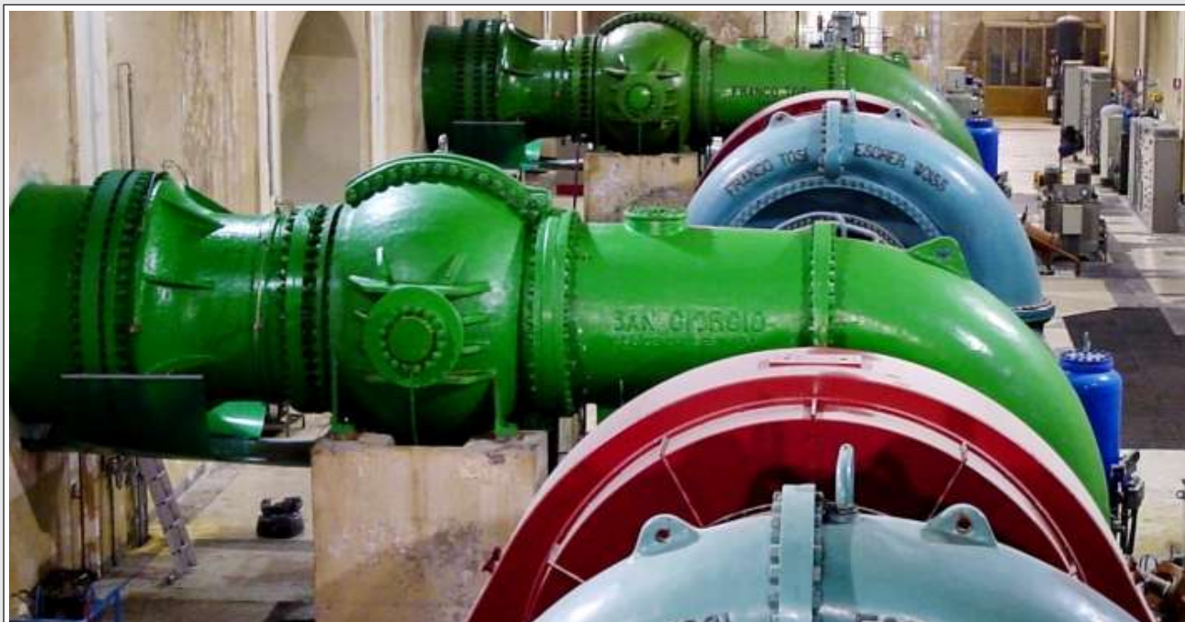
Le turbine della Centrale di Cotilia
