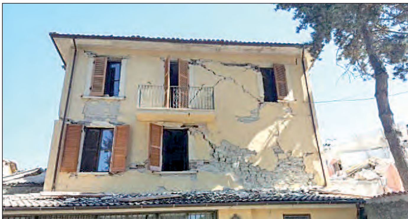
Figura 1: Lesioni tipiche di maschi murari, generate da azioni sismiche
